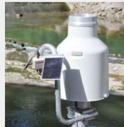
RTU con paneles solares en pie de mástil del sensor de precipitación
